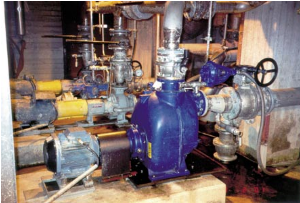
Gorman-Rupp T4-sarjan pumppu tosi toimessa. Taka-alalla vanhat Ahlströmin (Sulzer) pumput.
